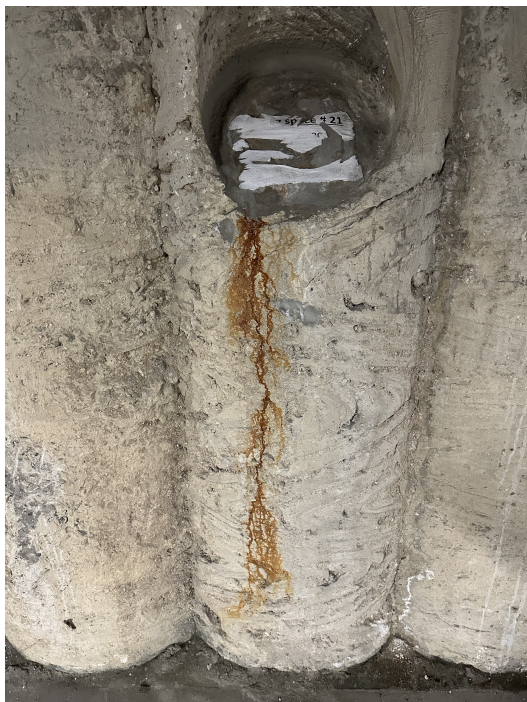
(c) Läckage från stag
