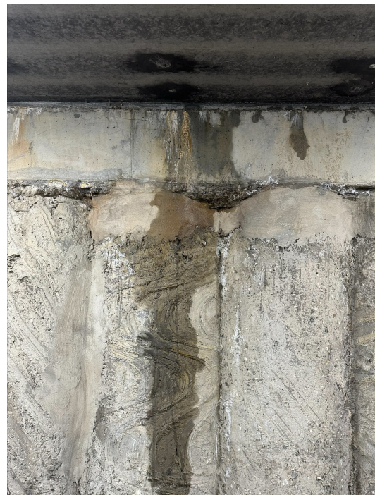
(d) Läckage från kantbalk
