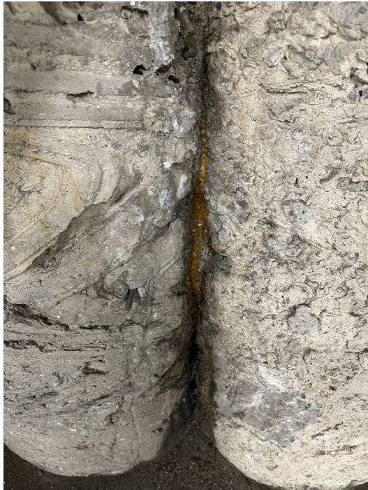
(a) Läckage i fogen
