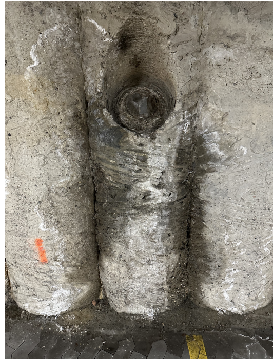
(b) Fukt i väggen
