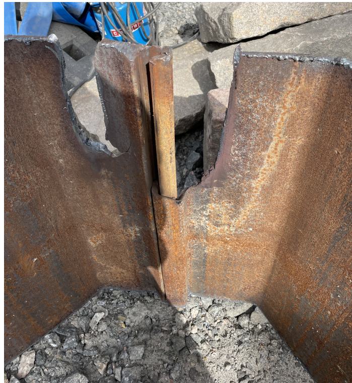
Figur 3.5: En spontplanka som har gått till brott i överkant vid avetablering. Foto: Patrik Hyberg.
