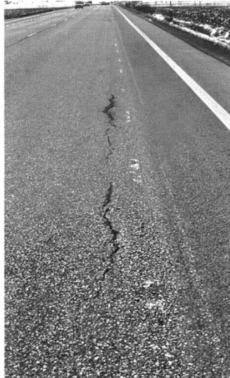
Figur 7-4: Sprickbildning i hjulspåret (VTI & Vägverket, 2003)
