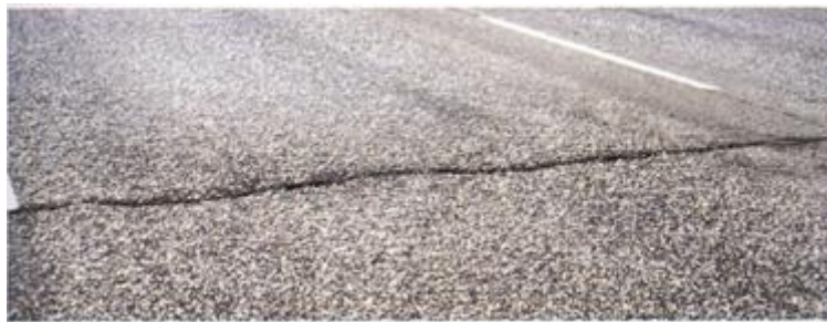
Figur 7-6: Tvärgående sprickor syns tydlig i vägen (VTI & Vägverket, 2003)
