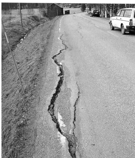
Figur 7-8: Kantspricka syns vid kanten av en väg (VTI & Vägverket, 2003)
